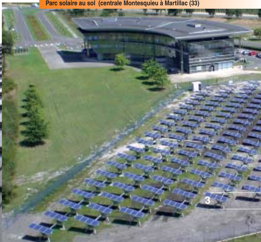
Parc solaire au sol (centrale Montesquieu à Martillac (33))
