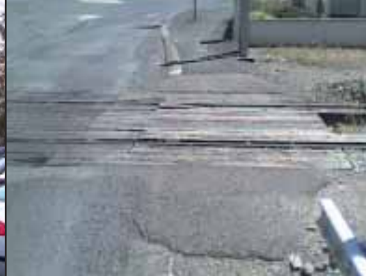
Traversée des voies inconfortable
